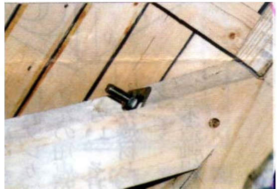
ほとんどの金物が緩んでいる
