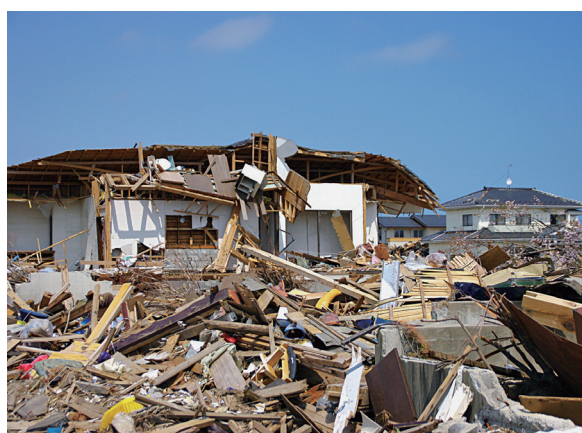
地震による災害は住宅に大きなダメージを与える
